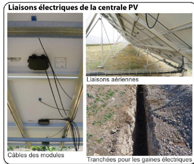
Photographie 50 : Liaisons électriques (Source :ENCIS Environnement)
