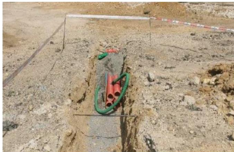
Photographie 51 : Exemple de fourreaux en tranchée (Source : SOG Solar)
